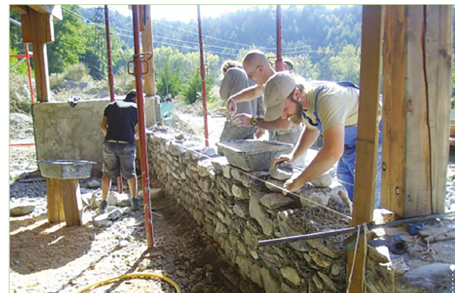
Le Gabion dispense des formations diplômantes, mais accueille aussi des personnes en insertion.
